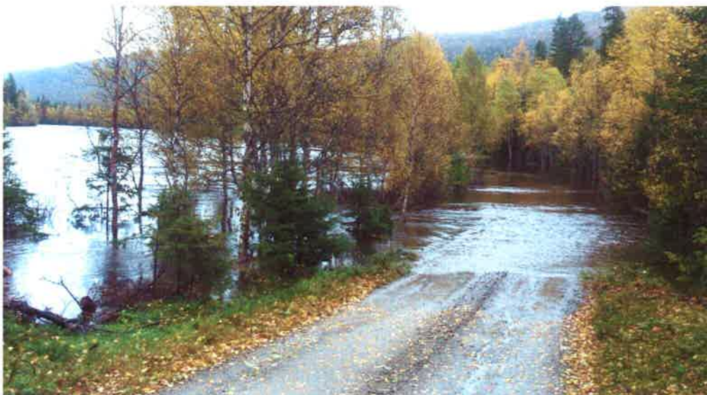
Lurudalsvegen fikk flomskader etter både vinterflom og høstflom i 2015.
